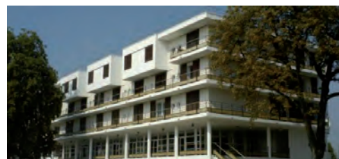
La rénovation du bâtiment qui accueillera la maison de retraite est en cours et ouvrira début 2016.
